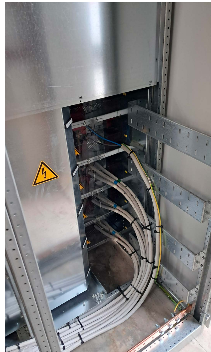
↑ Particolare collegamento linea con canaline e staffe di sostegno in acciaio zincato.
