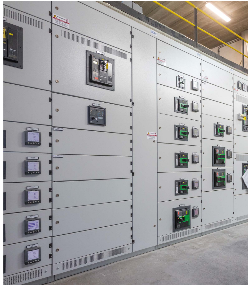
↑ Dettaglio vista d'insieme quadro Power Center installato.
