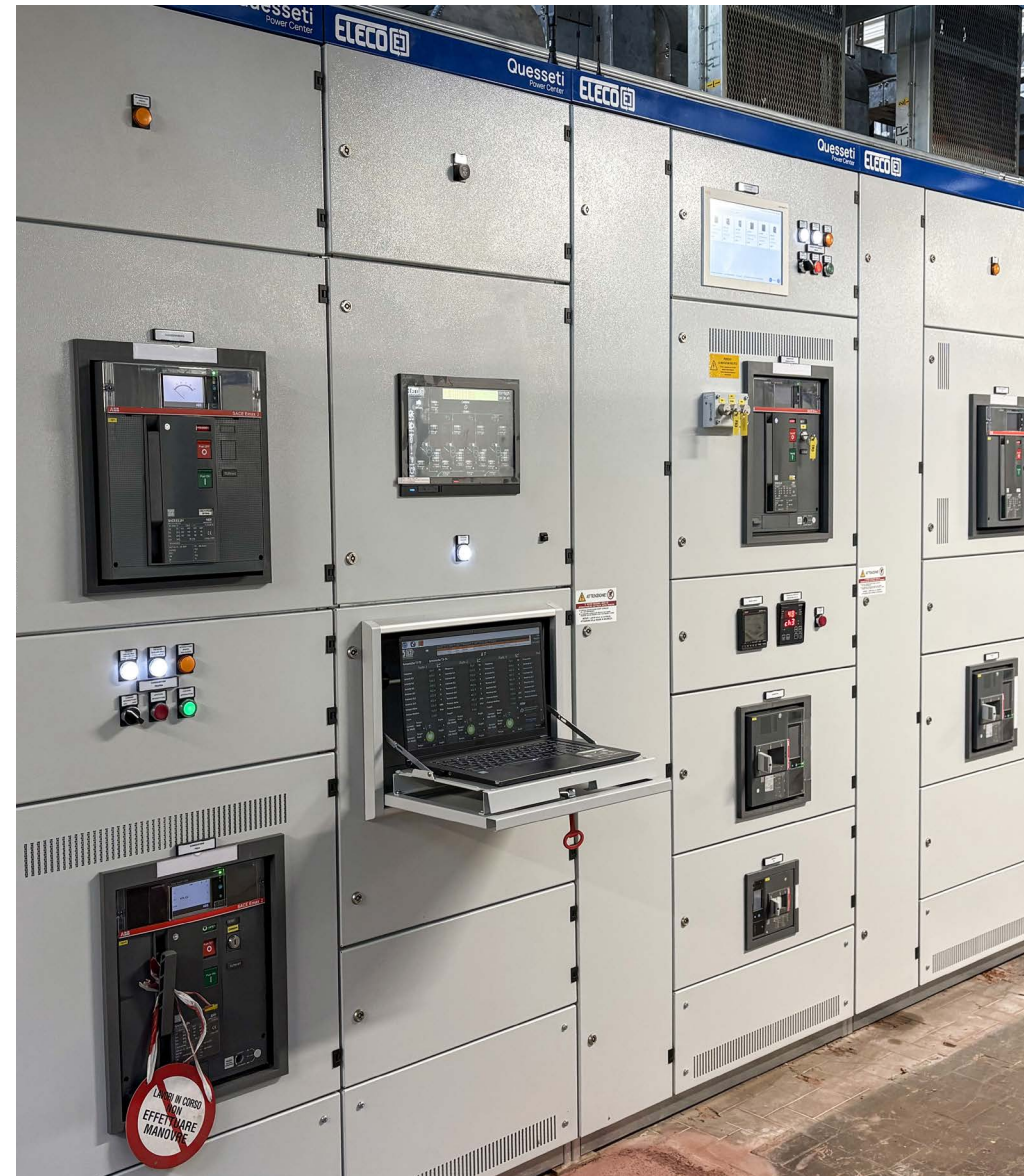
↑ Dettaglio del Power Center installato con integrazione del sistema SCADA.
