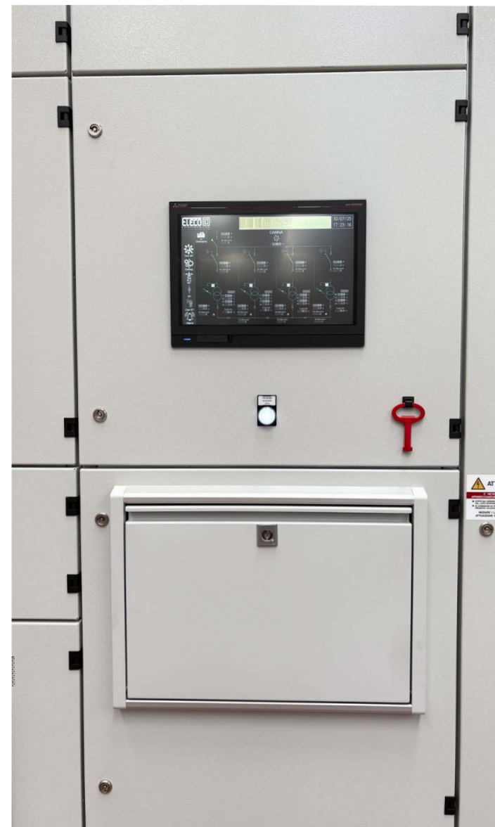
↑ Dettaglio frontale del Power Center con interfaccia SCADA.
